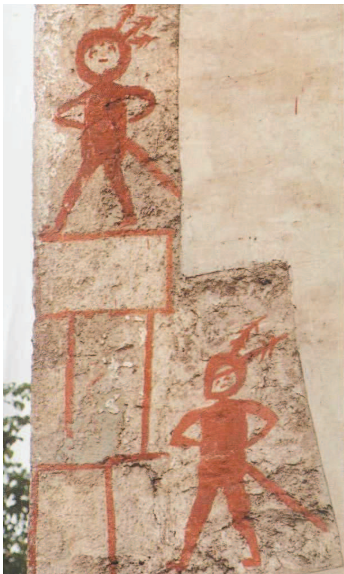
V Klášterci nad Orlicí v roce 1955 zedníci při opravě fasády odkryli malby dvou zvláštních postav. Asi jeden metr vysoké tvorové mají na hlavách helmy, zdobené podivnými stromkovitými útvary.
